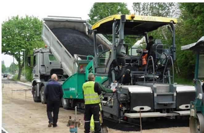
Viel Arbeit haben die Straßenbauer in der „Hockenheimer Straße“. Sie wird runderneuert und mobilitätsgerecht gestaltet.
