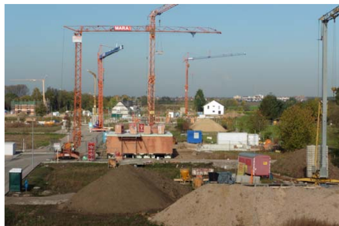
Dicht an dicht stehen die Baukräne im Wohnbaugebiet „Herten II“. Foto: jd
